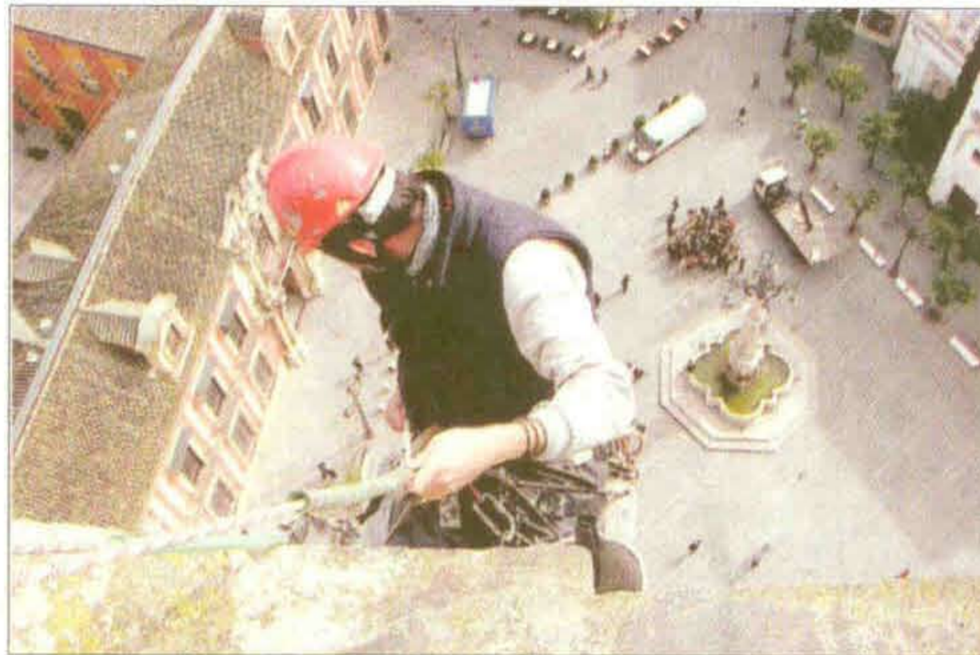
DESDE LAS ALTURAS. Un técnico revisa la fachada este de la Giralda.
